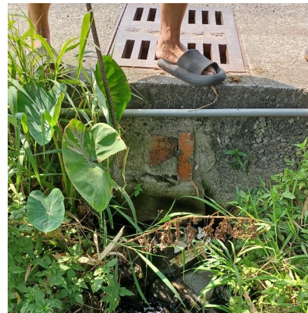
取水口破損，缺乏攔汙設計
